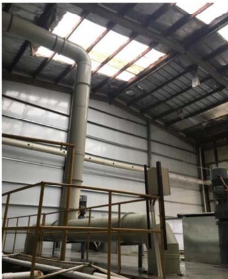
污泥收集池密闭抽气装置
