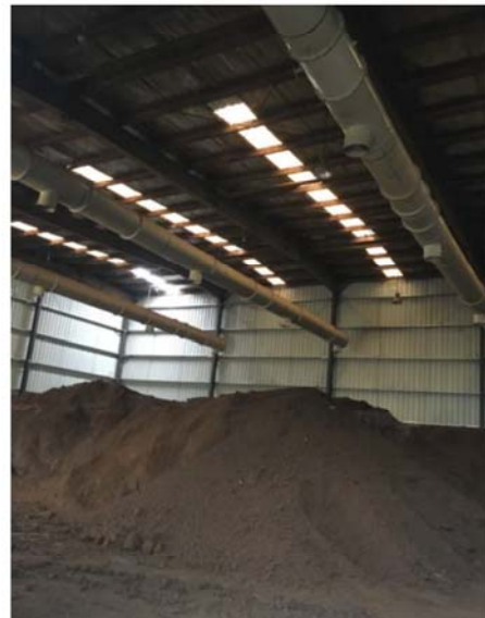
干泥仓密闭微负压抽集装置
