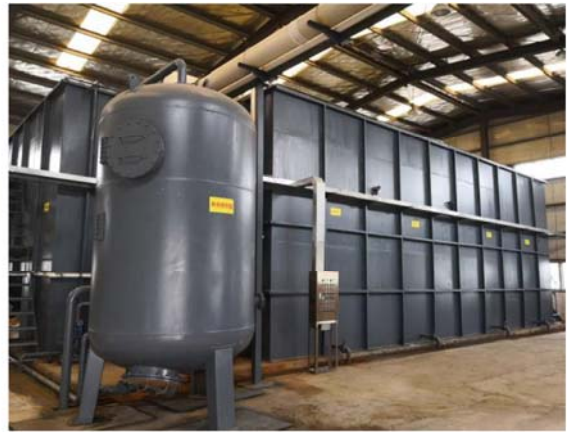
污水处理设施
